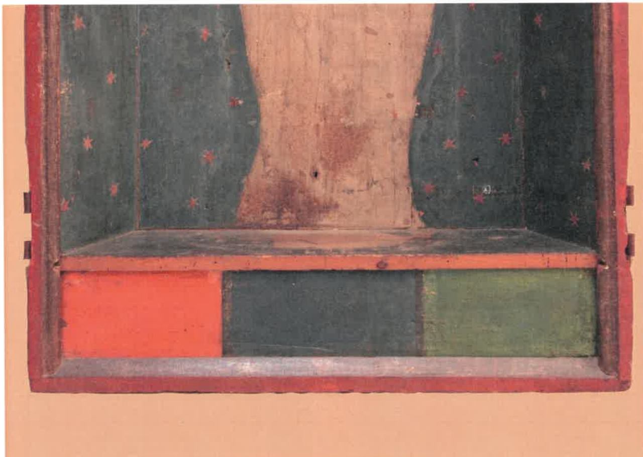
Dřevěná nika sochy svaté Barbory, polychromovaná architektura, stav před restaurováním – levý snímek dokumentuje rozvolnění spoje, pravá destrukcí dřevní hmoty v místě kovového závěsu.
