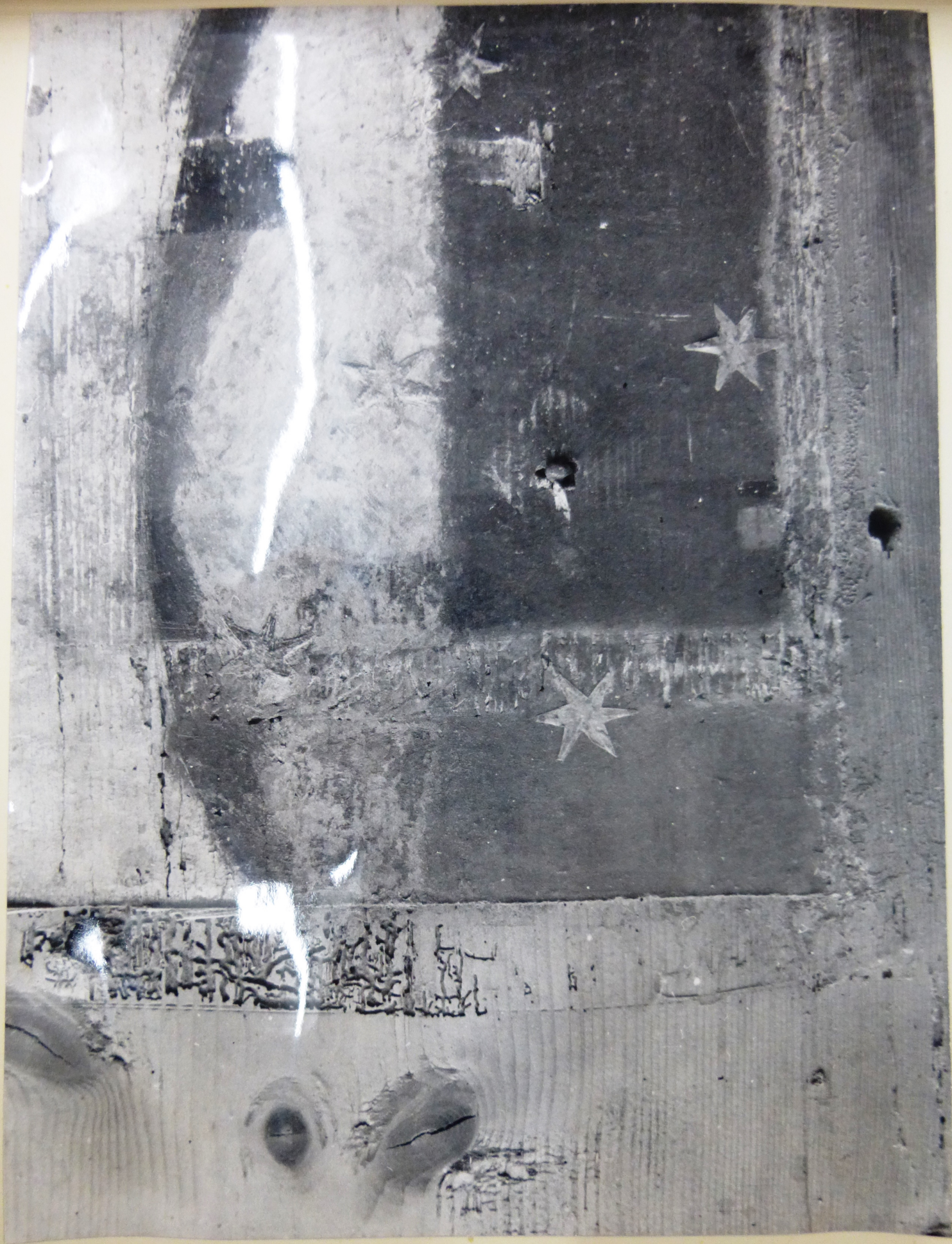
Detail se sondou a poškozením dřeva
